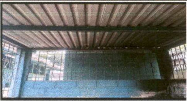
FOTO 11: COCINA CUBIERTA DE LAMINA,
